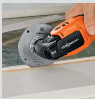
Protnutí hřebíků na zasklívacích lištách.
