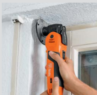
Rozříznutí krytů skříněk žaluzií.
